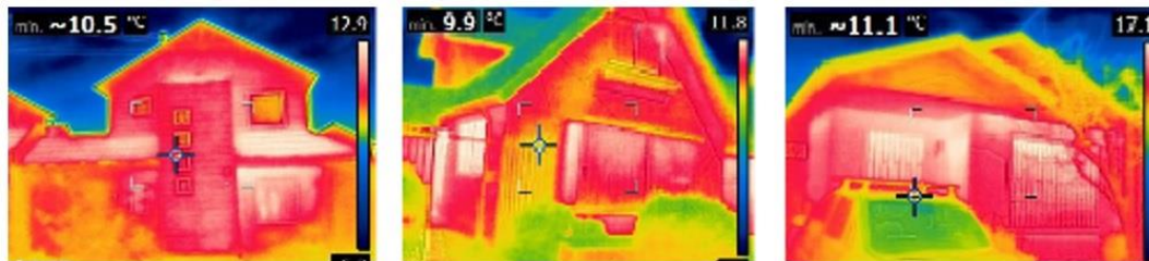
Figura 6. Fotografías termográficas, puentes térmicos, viviendas analizadas, Temuco año 2015. (Universidad Tecnológica de Chile, Área Académica Construcción).
